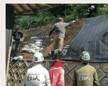
法面等の土砂崩れ
