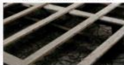
床下にたまった泥(写真③)
