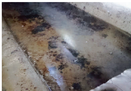
水が残って悪臭が発生する
