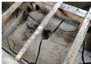
床下にたまった泥（写真③）
