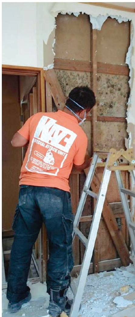
壁をはがすとカビが生えている
